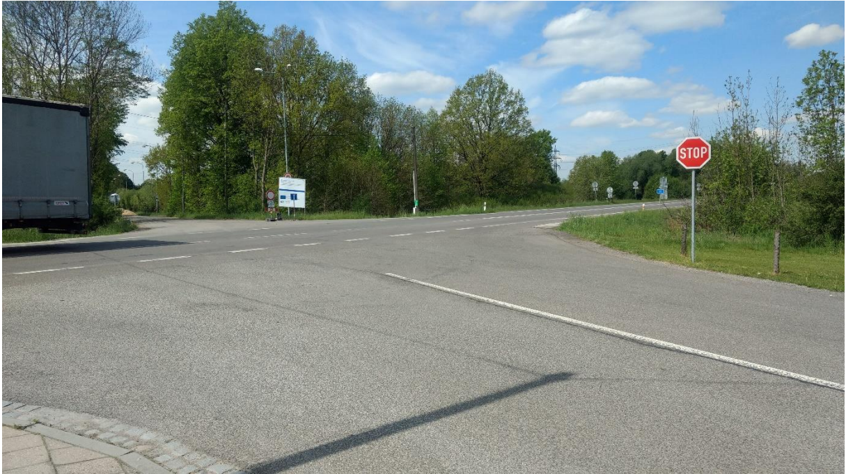
Obr.č.21 – Zde je částečně vidět nevhodné napojení obou vedlejších ramen
