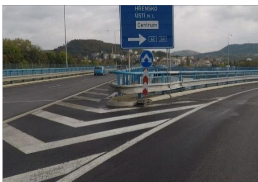
Obrázek 21 - Neadekvátně provedené svodidlo. UK (ID 7484)
