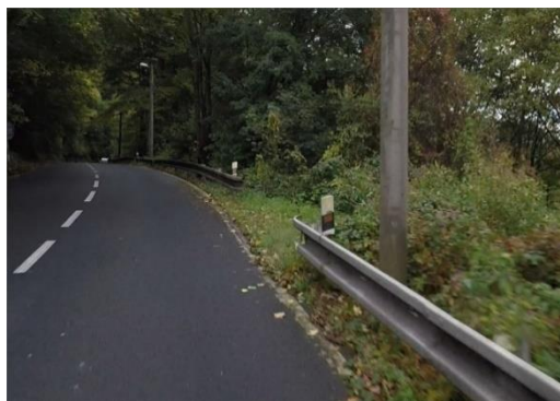
Obrázek 20 - Neadekvátně realizovaný začátek svodidel. UK (ID 9126)
