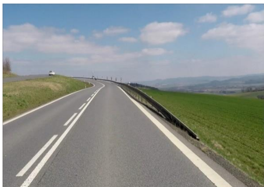
Obrázek 19 - Neadekvátně realizovaný začátek svodidel. PLZ (ID 1718)
