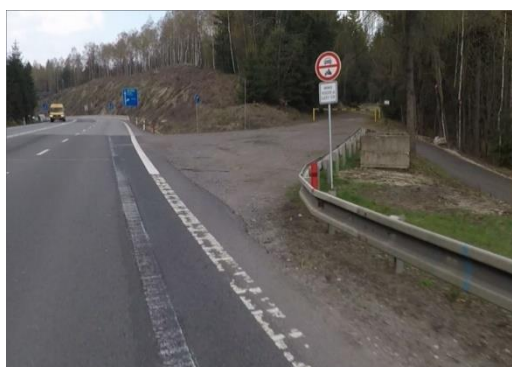
Obrázek 22 - Neadekvátně provedené svodidlo. LK (ID 5420)
