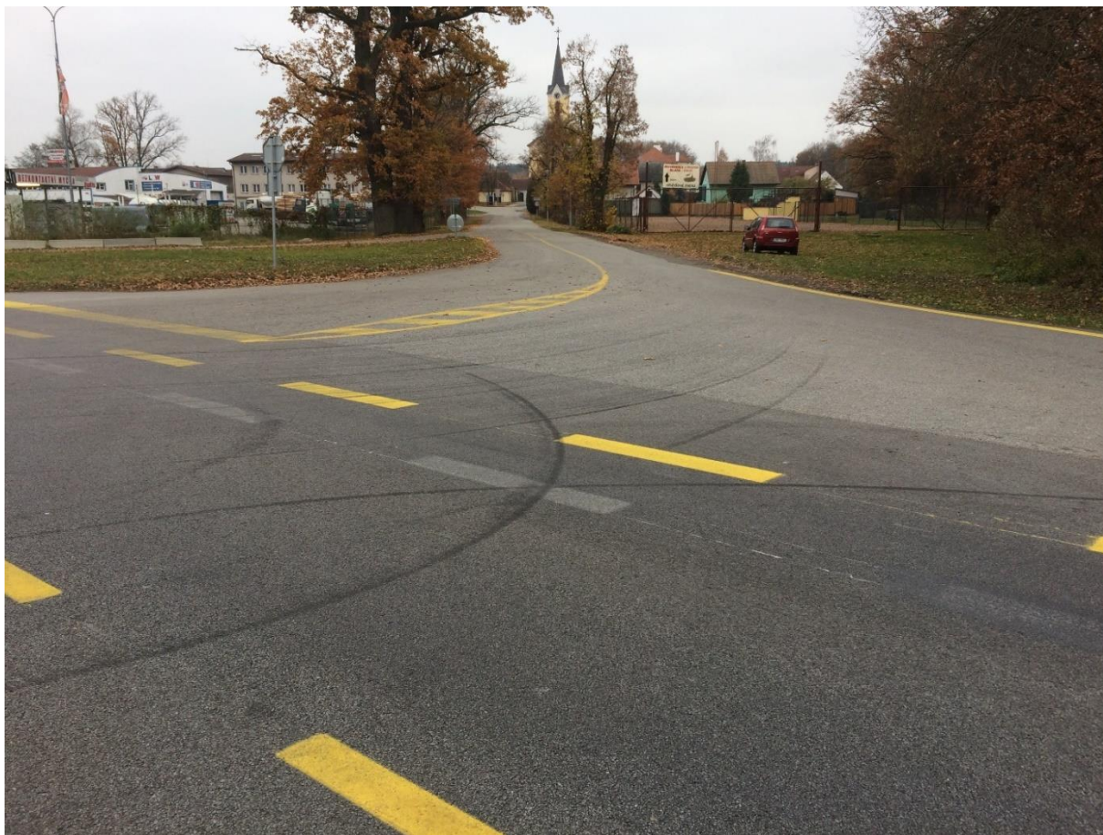
Obrázek 4 – Povrch vozovky na křižovatce „A“ [zdroj: archiv autora, 2018]
