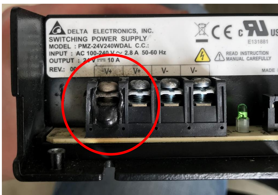
Obrázek 12 - Zákaznická reklamáce, spálené konektory [vlastní foto]
