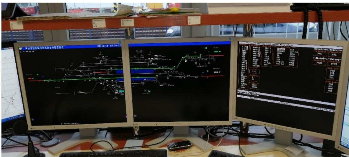
Obrázek 23: Pohled na jednotné obslužné pracoviště v dopravní kanceláři v ŽST Strakonice
