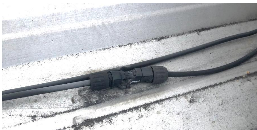
Obrázek 5.3 Poškozený konektor na plechové střeše.
