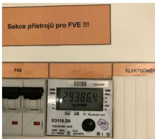
Obrázek 8.6 Popsané jednotlivé ochranné prvky na FVE2
