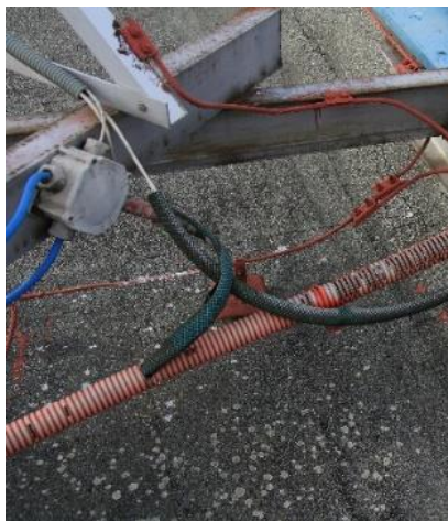
Obrázek 5.9 Ukázka poškozených chrániček
