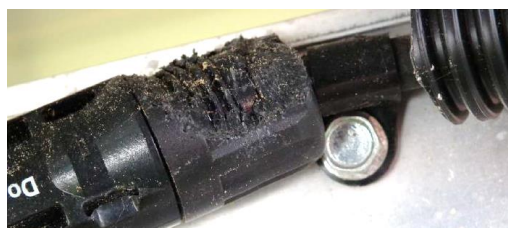
Obrázek 5.12 Poškozený konektor – poškozený hlodavcem (laborař ČVUT FEL)
