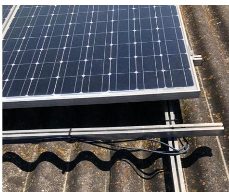
Obrázek 8.4 Odkryté vodiče na FVE6
