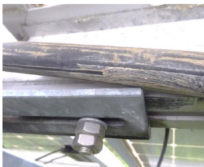
Obrázek 5.11 Tření vodiče a konstrukce – špatné umístění kabelů
