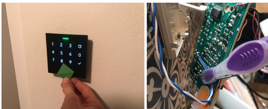
Obrázek 2.11: Přístup do bytu - vlevo NFC čtečka, vpravo úprava desky domovního telefonu
