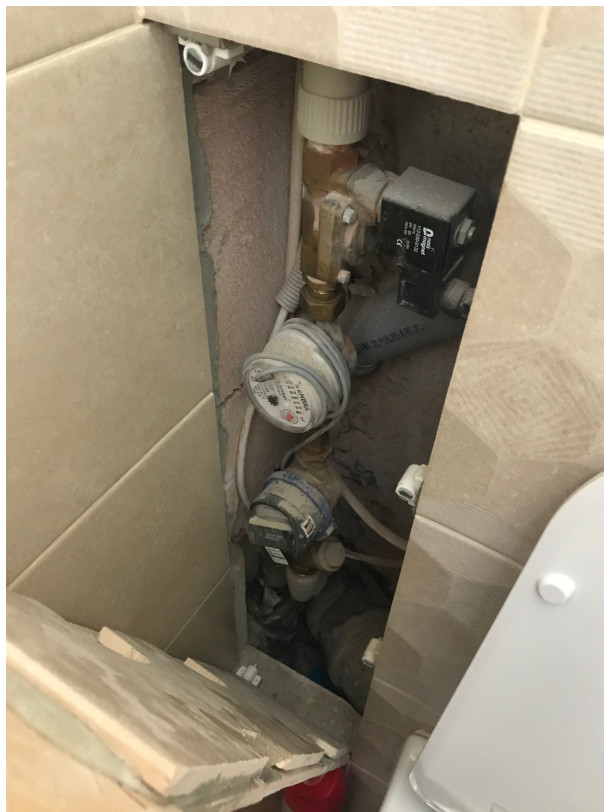
Obrázek 3.1: Elektromagnetický ventil 2VE16IDA 24VDC, vodoměr ENBRA ER-AM s impulzním výstupem
