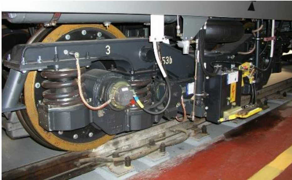
Obr. 17.: Napájení třetí kolejnicí pražského metra [7]
