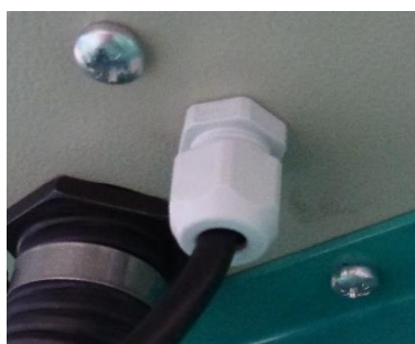
Obrázek 77 Instalovaná plastová průchodka napájecího kabelu
