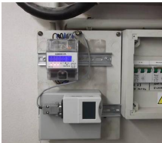
Obr. 5 Fotografie připojení dataloggeru S7021 ke statickému elektroměru [11]
