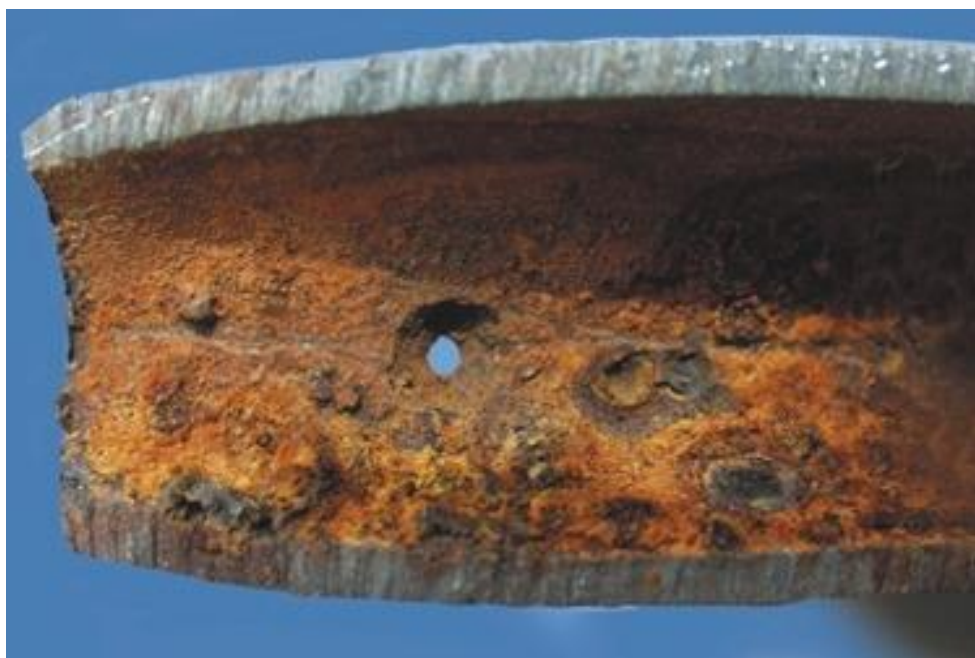
Obrázek 5. Důlková koroze v ocelovém potrubí [4].
