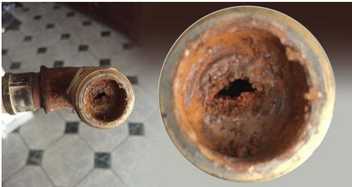
Obrázek 1. Ukázka koroze vnitřního povrchu potrubí [1].
