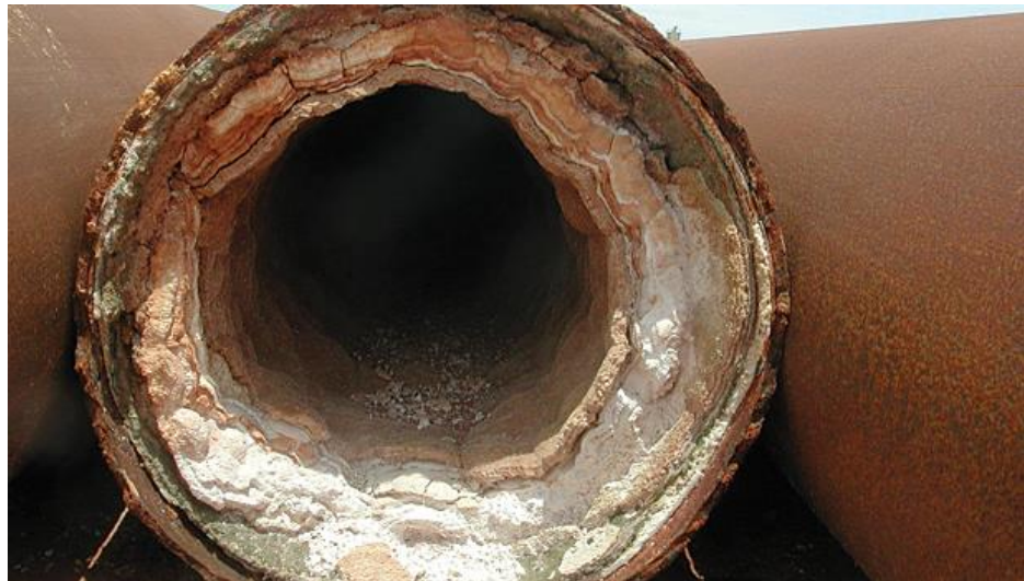
Obr. 11 - Zanesená trubka tepelného výměníku [24]
