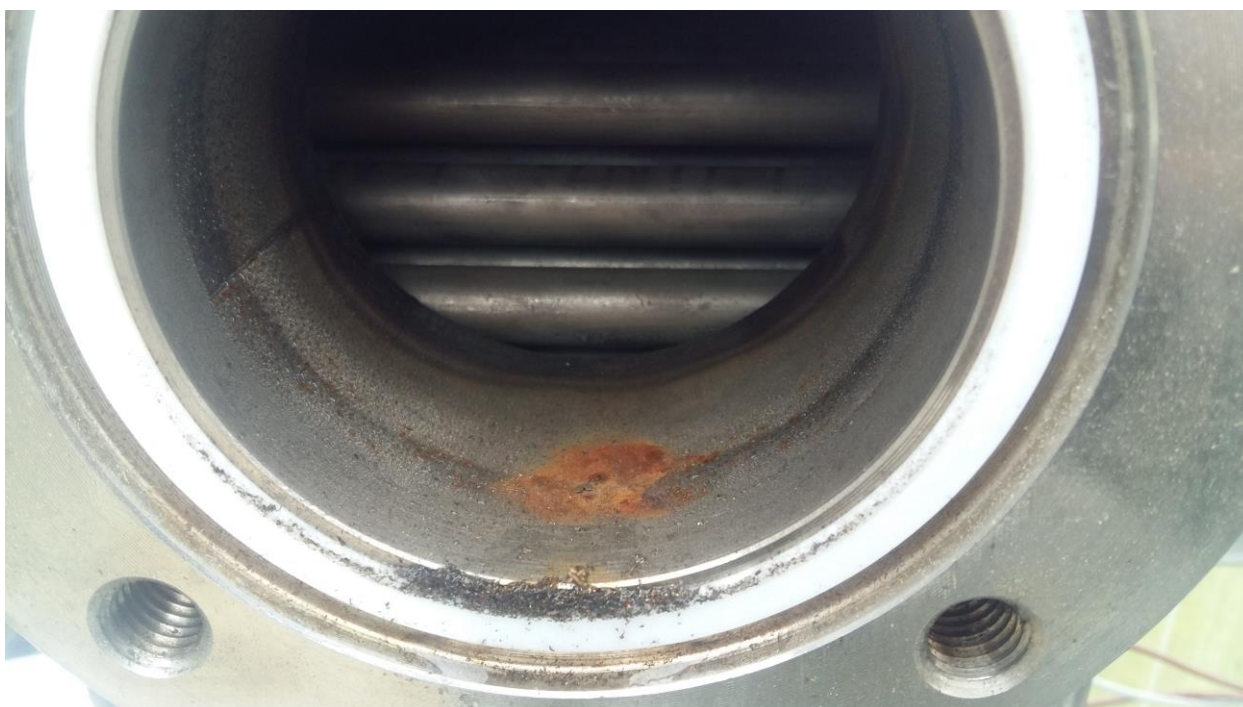
Obr. 49. Demontáž průhledítka desorbéru, přítomnost nečistot v těsnění
