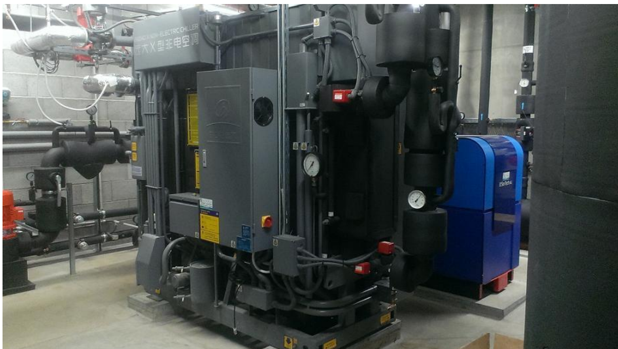
Obr. 9. Absorpční chladič BDH6X80/90-38,5/33,5/12-20, instalace UCEEB ČVUT
