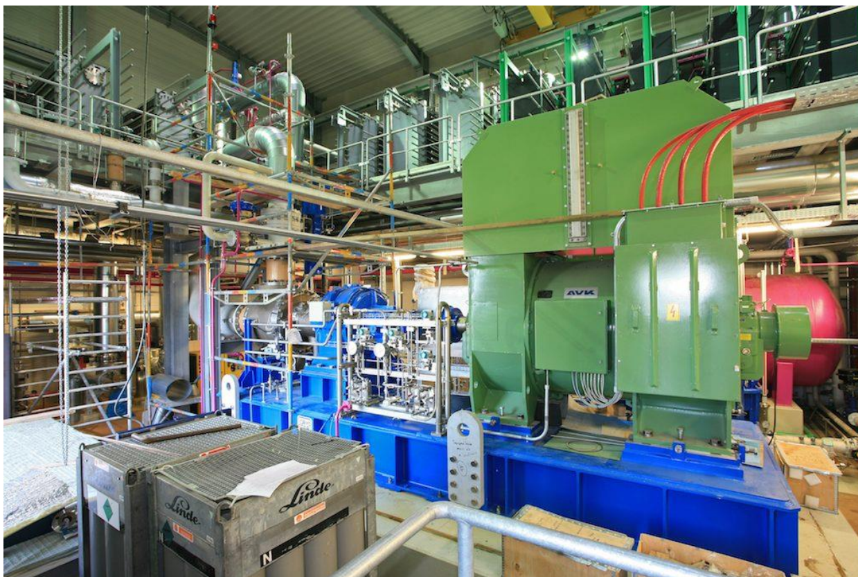
Obr. 10. Geotermální elektrárna s Kalinovým oběhem [6]
