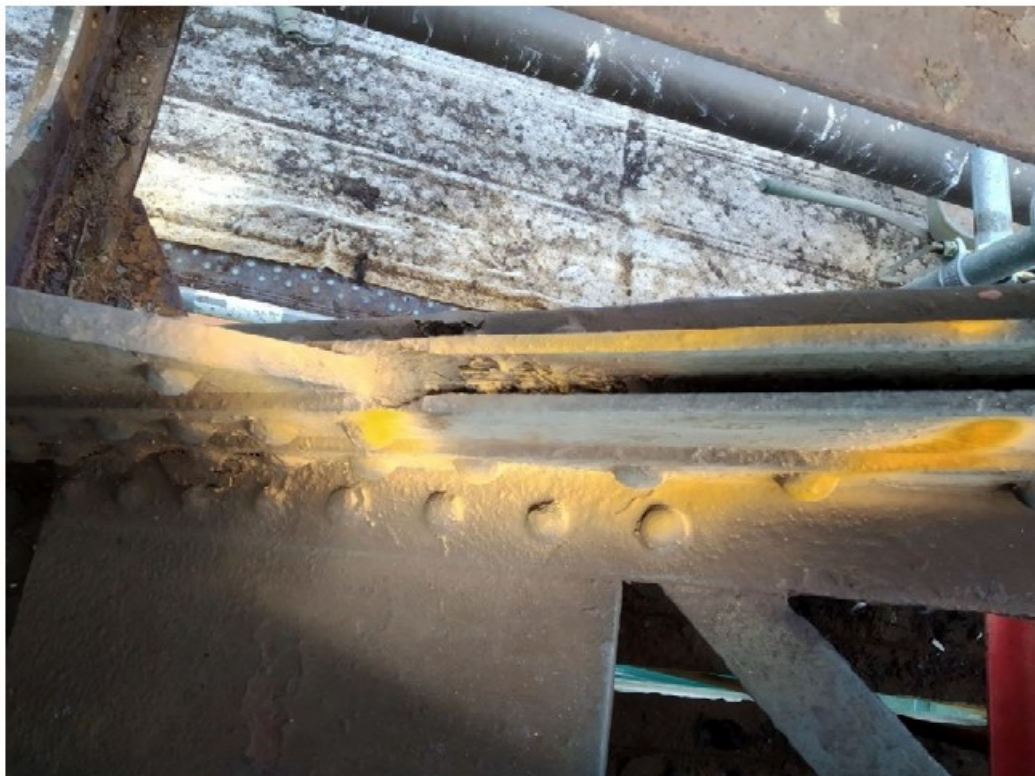
Fotografie štěrbiny nad dolním pasem
