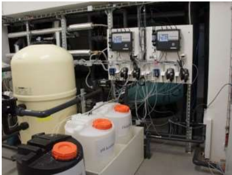
Obrázek 5 Automatické dávkování dezinfekce bazénové vody [23]
