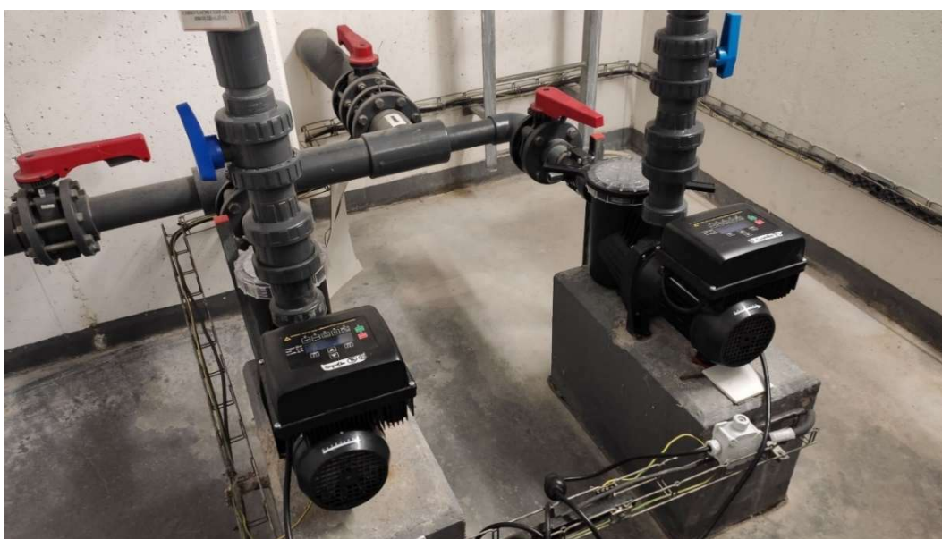
Obrázek 31 Nová čerpadla ve strojovně bazénu [15]
