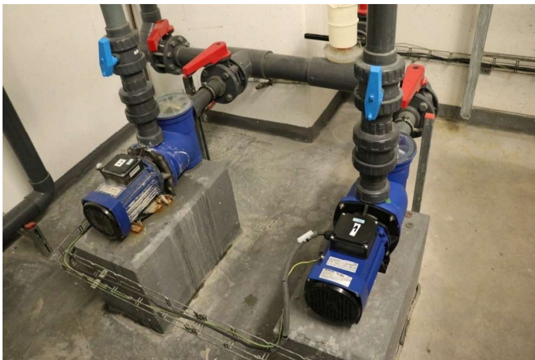
Obrázek 30 Původní čerpadla osazená v recirkulačním systému bazénu [16]
