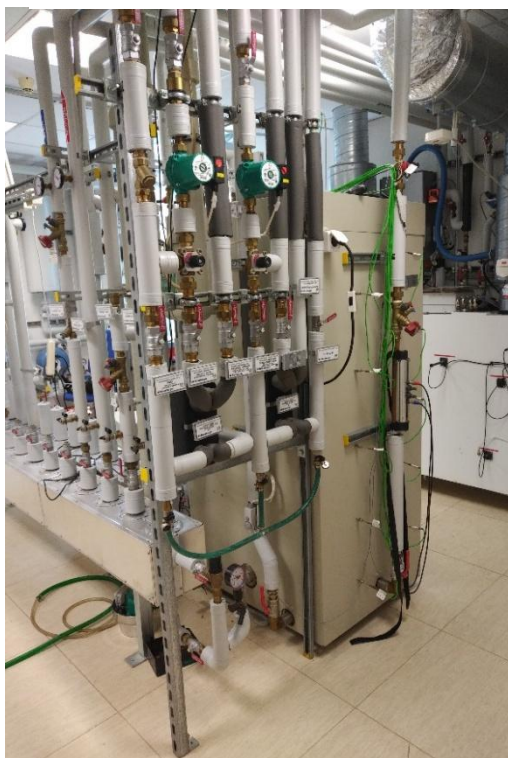
Pohled na hlavní ovládání zásobníku – obr. 23
