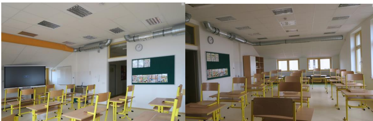
Obr. 19 ZŠ Malý Újezd. Přívod vzduchu textilními rukávci a odvod vzduchu vyústí [12]
