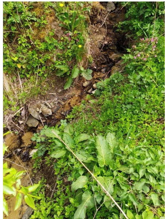
Obr. 18 - Prítok zarezaný v údolí s viditeľnou eróziou a usadenými splaveninami
