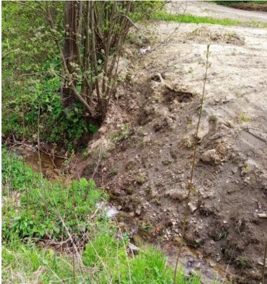
Obr. 29 - Zosuv zeminy do koryta
