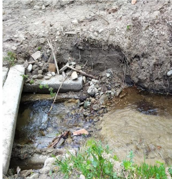
Obr. 30 - Nespevnené premostenie cez koryto
