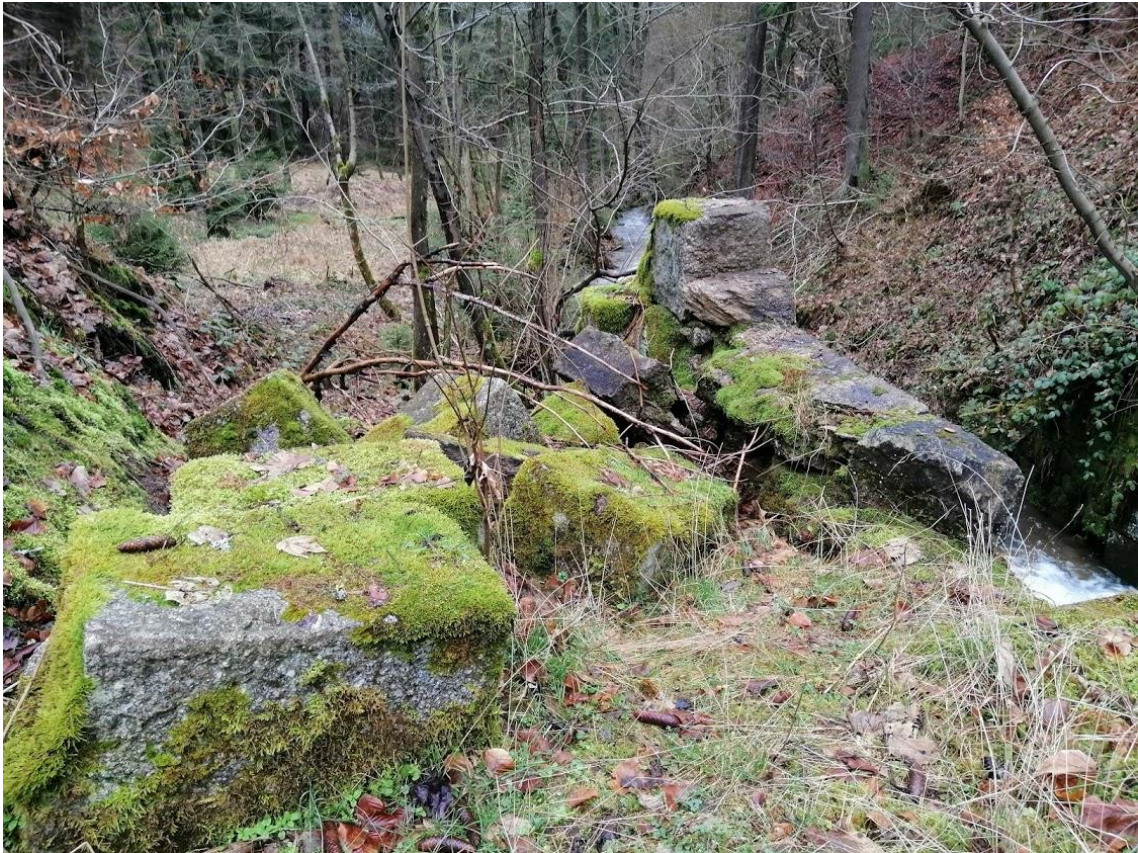
Obr. 20: Zborcená stěna bezpečnostního přelivu
