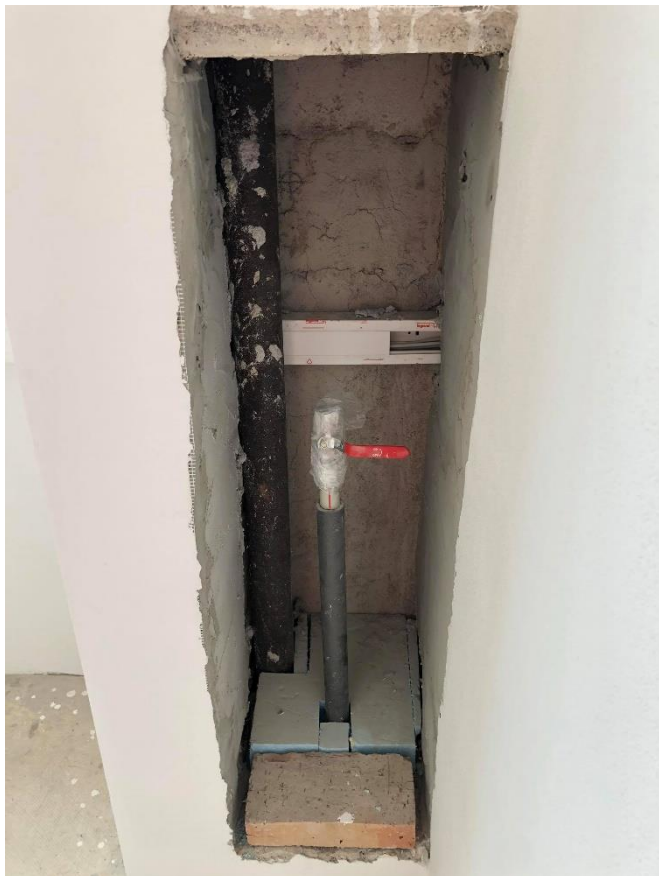
Obr. č. 42: Umístění přívodního potrubí a lišty s elektrickým vedením v 2.NP objektu
