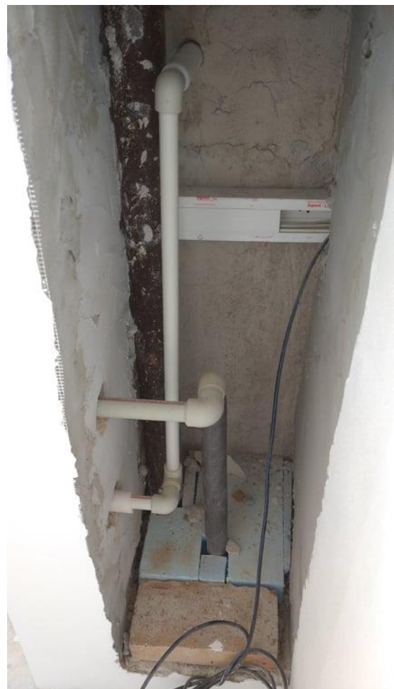
Obr. č. 46: Trubní přípravy pro přívod vody a elektrického vedení uvnitř kolektoru
