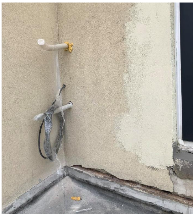
Obr. č. 47: Přívod vody a elektroinstalace v exteriéru objektu
