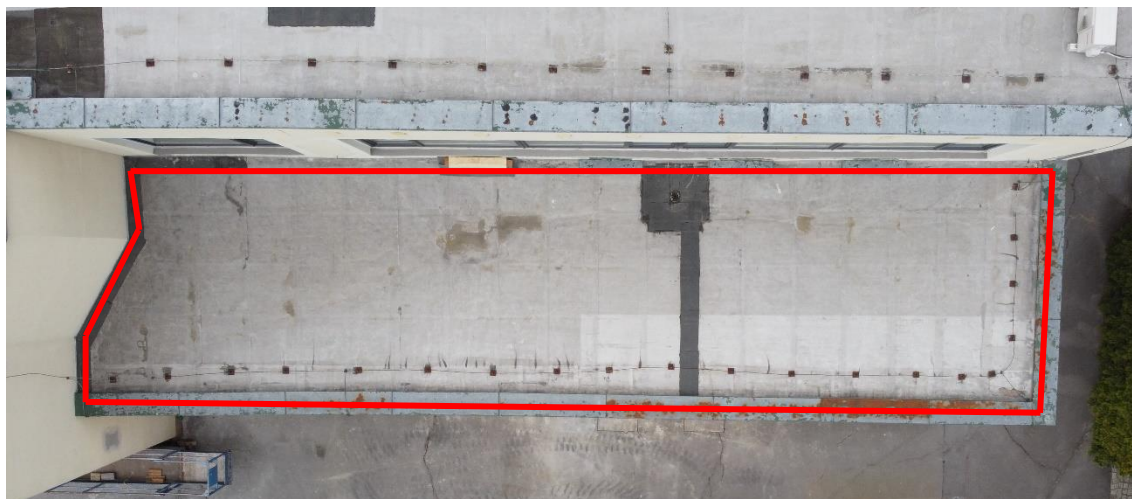
Obr. č. 29 Pohled na stávající střechu s vyznačenou řešenou plochou (foto: Ing. Lukáš Mihula)
