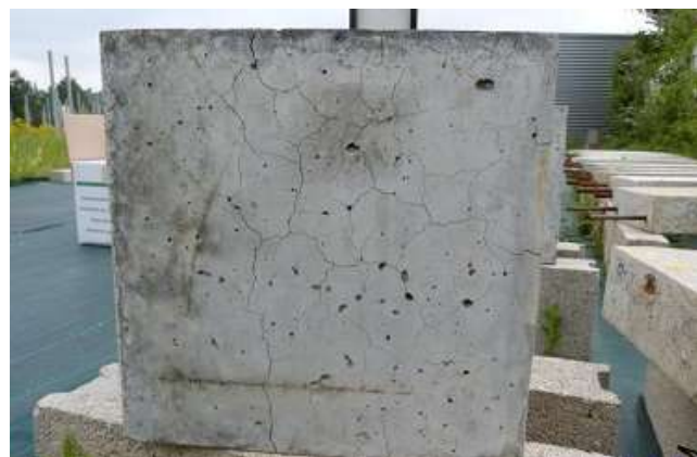
Obrázek 8 - Železobeton poškozený opožděnou tvorbou ettringitu [5]
