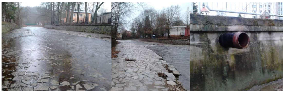
Obrázek 38 – Další problémy současného koryta v řešeném úseku Zdroj: Autorské fotografie
