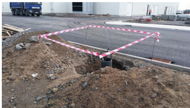
Obrázek 20: Vyznačení výkopu v nedostatečné vzdálenosti od jeho okraje [archiv autora]
