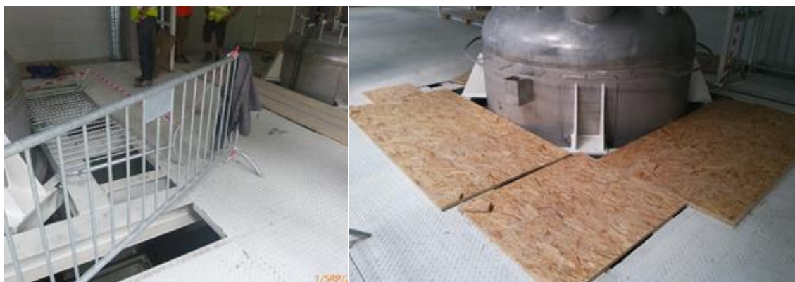
Obrázek 48 (vlevo): Nezabezpečený otvor v podlaze ve výšce 12m [archiv autora]
