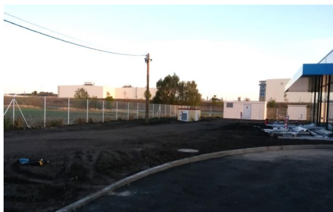
Obrázek 11: Dočasná trafostanice napojená na spínací stanici a dočasné elektrické vedení pro potřeby stavby [archiv autora]
