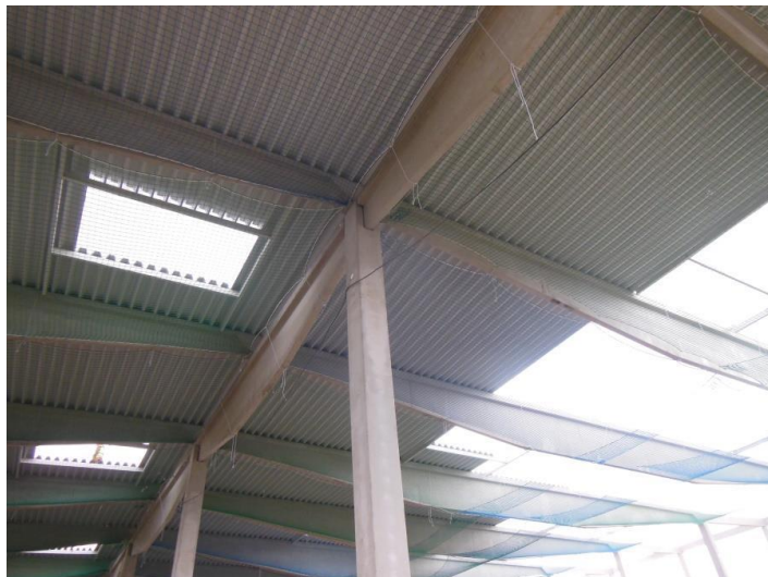
Obrázek 15: Záchytné sítě proti pádu osob zavěšené pod střešními vazníky [archiv autora]
