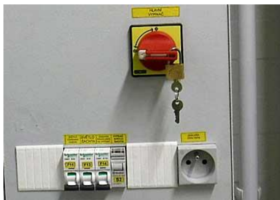
Obrázek 13: Vypínač zdroje elektrického zařízení se zabezpečením proti neoprávněné manipulaci [www.elektromoravek.com]
