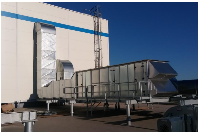
Obrázek 42: Vzduchotechnické jednotky umístěné na střeše výrobního objektu [archiv autora]
