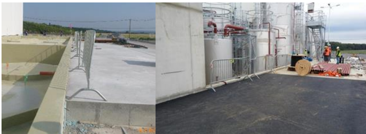
Obrázek 46 (vlevo): Nedostatečně zabezpečená pádová hrana [archiv autora]
