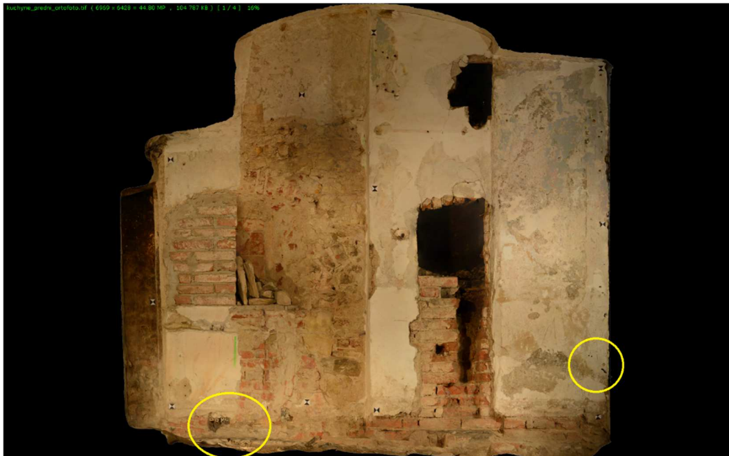
Obr. 26: Kuchyně, přední stěna - chyby
