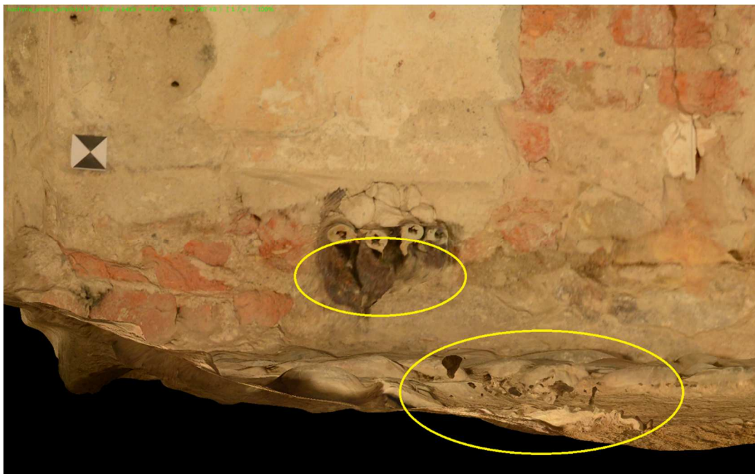
Obr. 27: Kuchyně, přední stěna – chyby (detail A) nahoře lze vidět rozmazaný obraz a ve spodní části, stejně jako na obrázku Obr. 28: Kuchyně, přední stěna – chyby (detail B) můžeme spatřit jamky.
