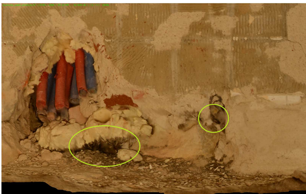
Obr. 30: Kuchyně, zadní stěna – chyby (detail)
