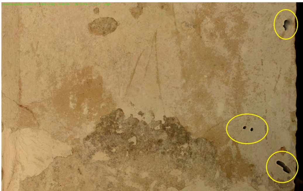
Obr. 28: Kuchyně, přední stěna – chyby (detail B)
