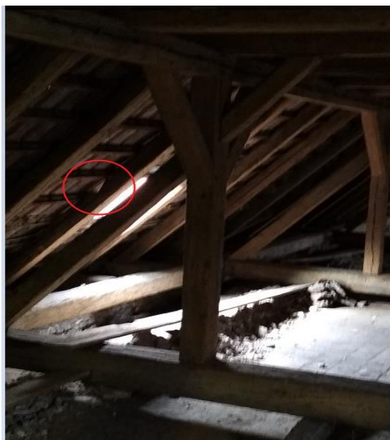
Obr. 29 - oslabený průřez krokve [40]
