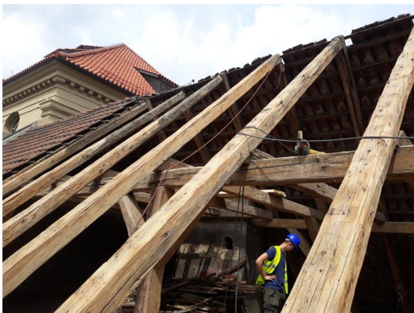
Obr. 45 - poškození krokví v horní části [40]
