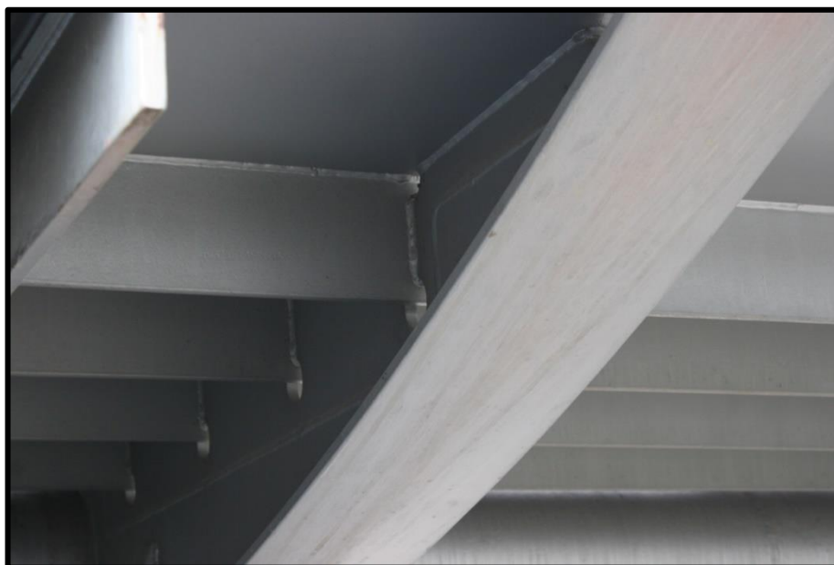
Obr. 17 Únavové detaily v místě styku podélných výztuh s příčnickem
