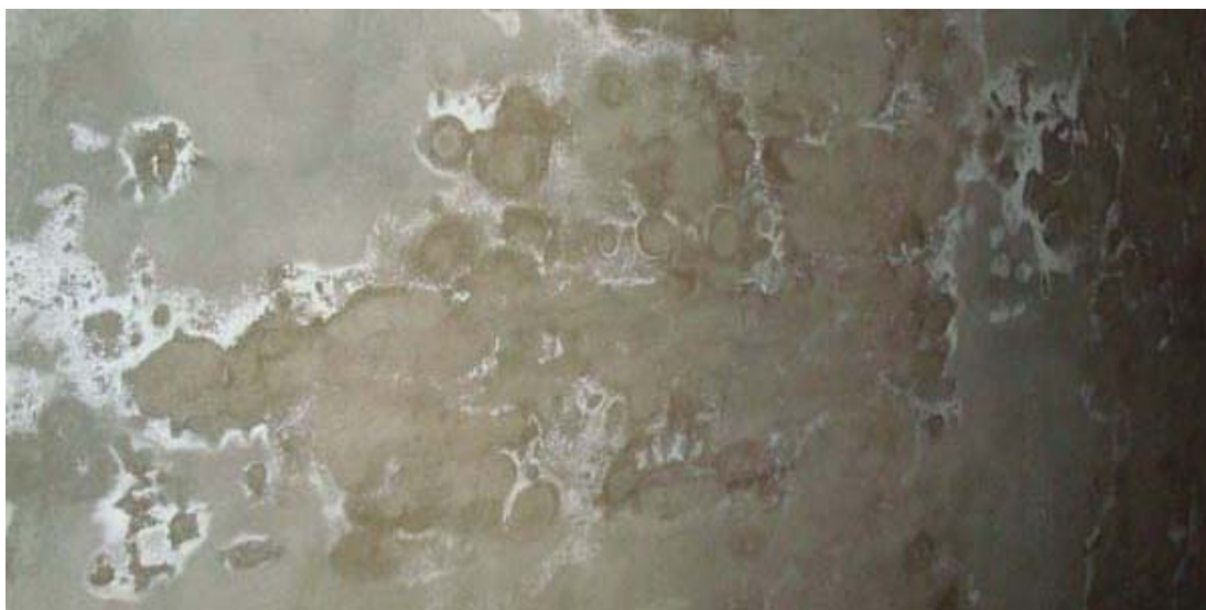
Obr. 13: Solné výkvěty na omítce, zdroj: [25]
