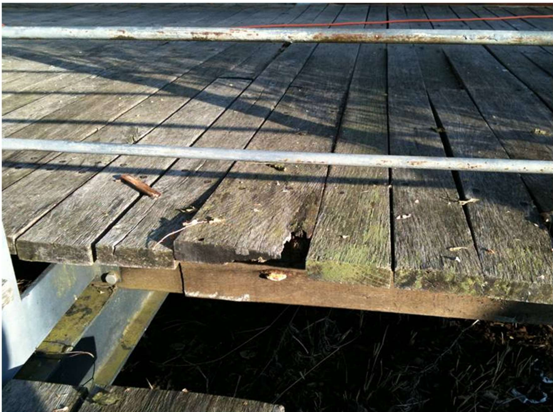
Obrázek 74 Příklad neudržované terasy po 10 letech od realizace
