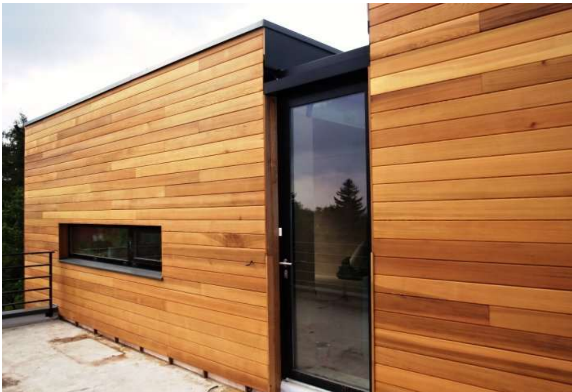
Obrázek 60 Fasáda ze západního červeného cedru
