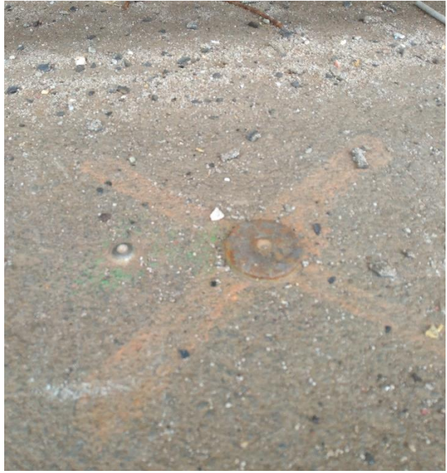
Obr. 12: Detail B: vlevo bod Z-4000, vpravo chybně zvolený hřeb pro stabilizaci bodu
