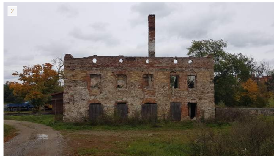
2 VODNÍ MLÝN Objekt využívaný jako mlýn až do 20. století. V současné době je nevyužívaný a v havarijním stavu. Je kulturní památkou a v ochranném pásmu NKP Sázavský Klášter.
