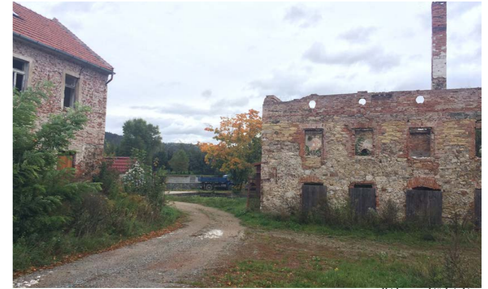
rozpadlý hospodářský dům
