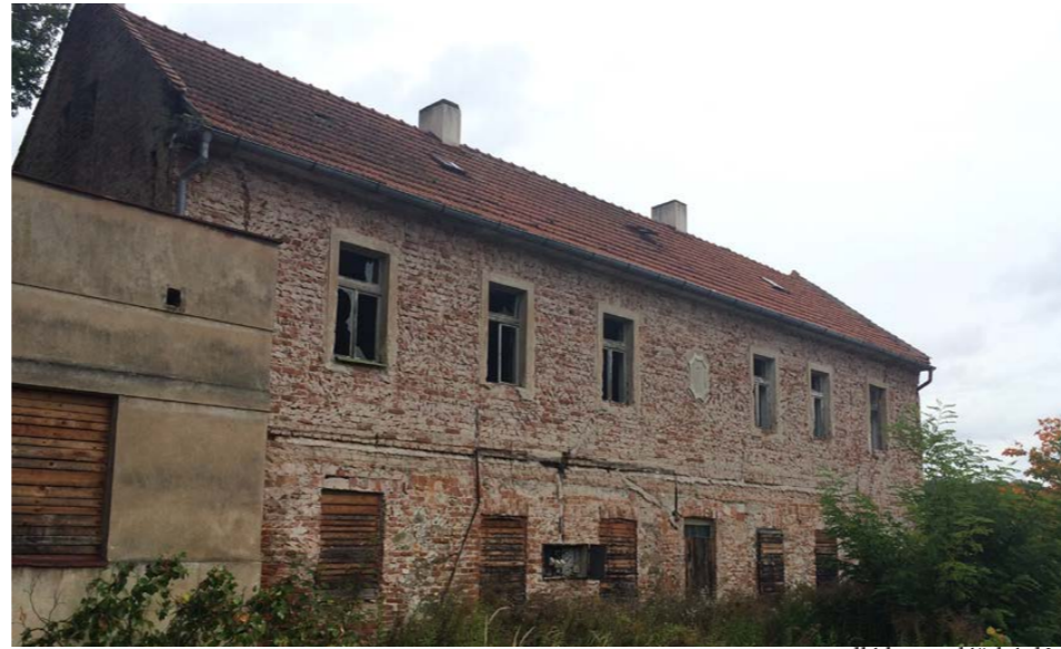
rozpadlý hospodářský dům
