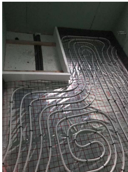
Obr. 42 Detail II. PT rozvody v koupelně (Fotografie autora práce)
