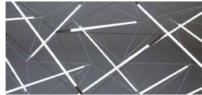
Osvětlení na mostní konstrukci - při stropě
