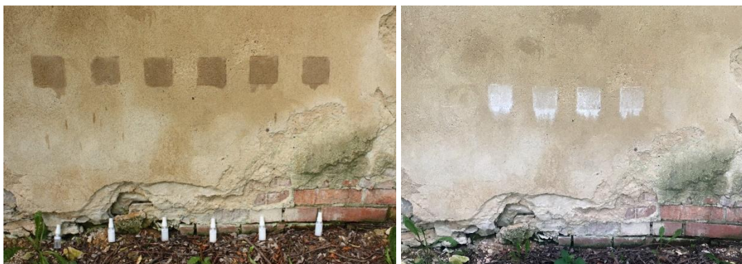
Obr. 80 Měření koheze podpovrchových vrstev omítané kamenné (opukové) zdi v Praze Zprava: omítka po 1. aplikaci, omítka po aplikaci 20 ml konsolidantů Legenda: zleva – CA, CA3, CA4, CA5, CaMg a CaL
