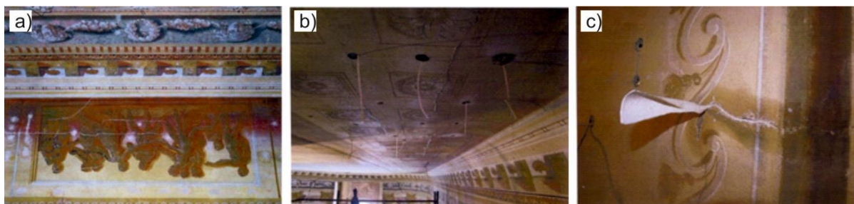
Obr. 13 Státní zámek Uherčice: a) iluzivní malba; b) stabilizace husté sítě prasklin tampóny z nanotextilie PVA; c) detail vyplnění trhlin tampóny z nanotextilie PVA
