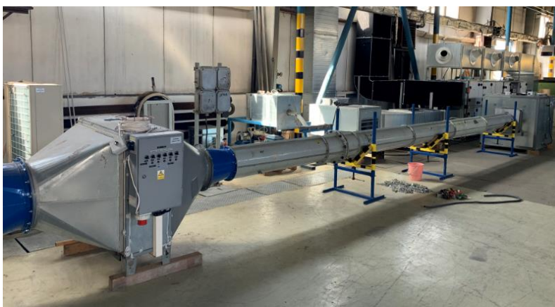
Obr. 20.: Měřicí trať. [Foto autor]
