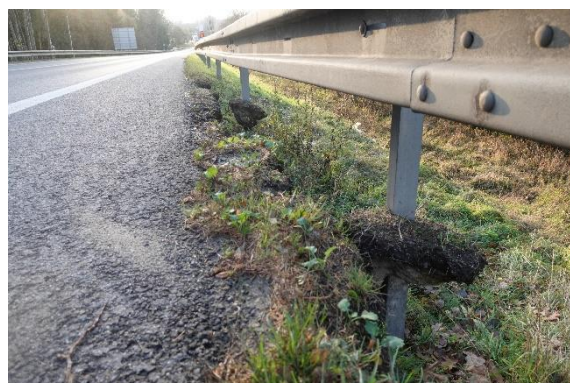
Obrázek 38 – Detailní pohled na neadekvátně upevněná svodidla. [29]
