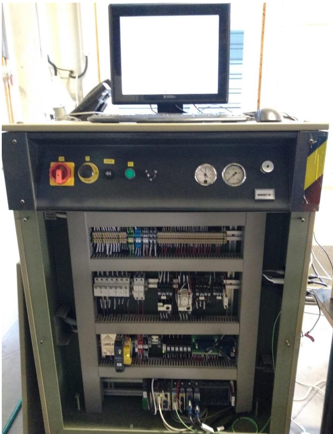
Obrázek 8: Řídicí systém hydraulické rychlotrhačky po modernizaci v roce 2019
