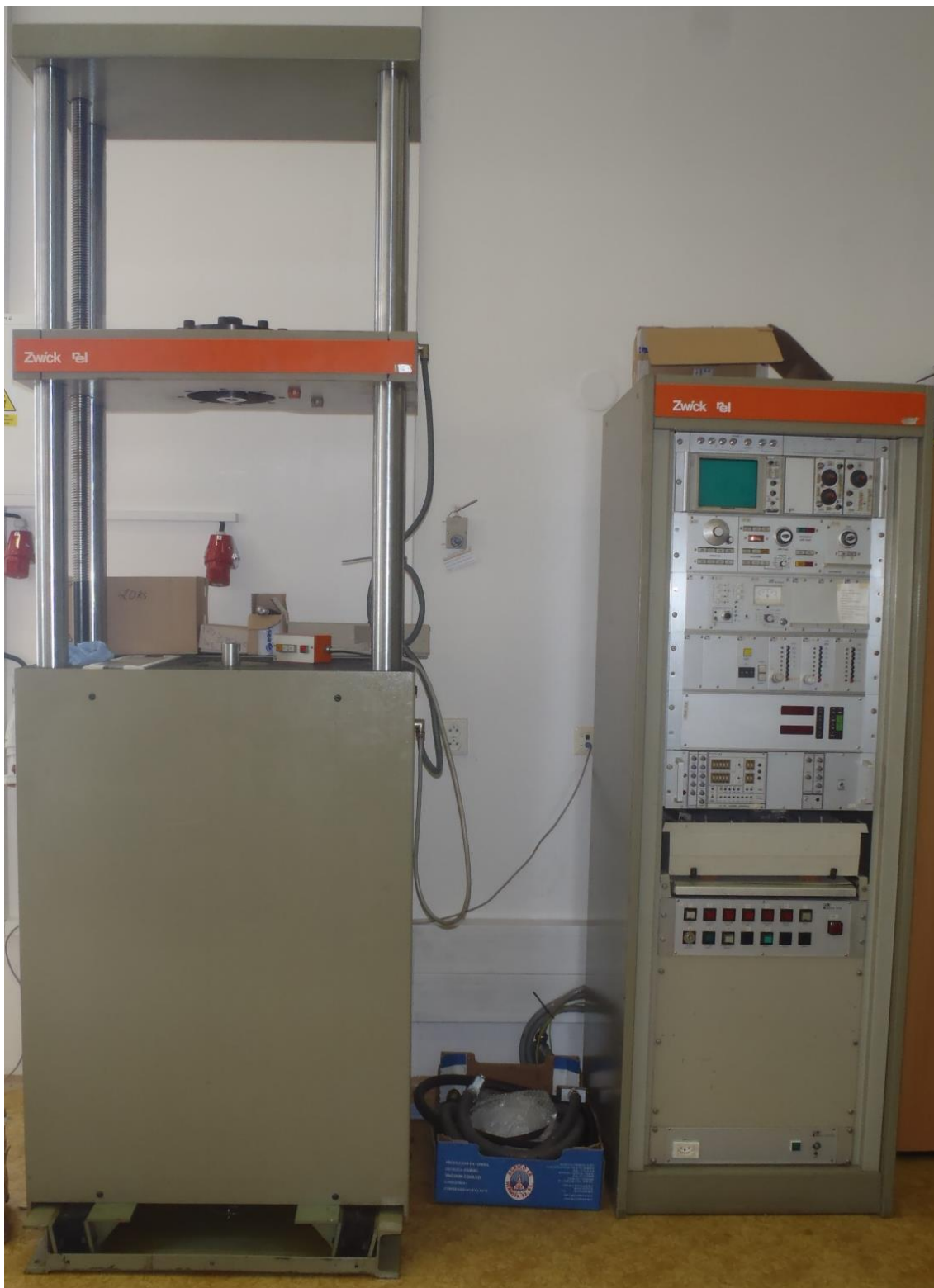
Obrázek 7: Hydraulická rychlotrhačka Zwick 1873 před modernizací v roce 2019
