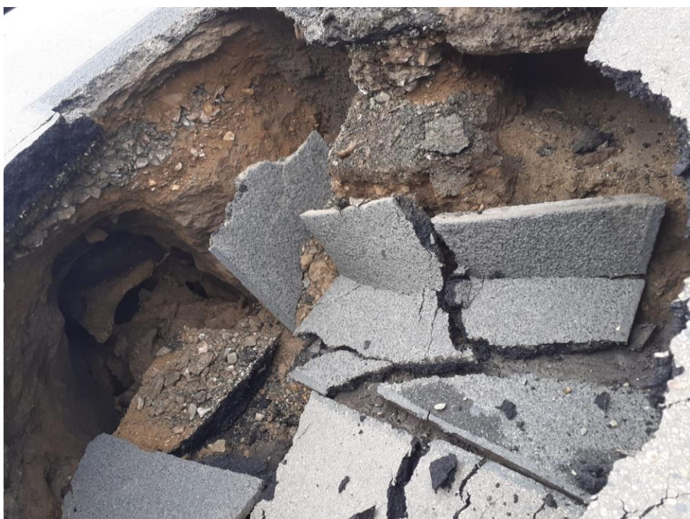
Obrázek 14 - propad betonové kanalizace [12]
