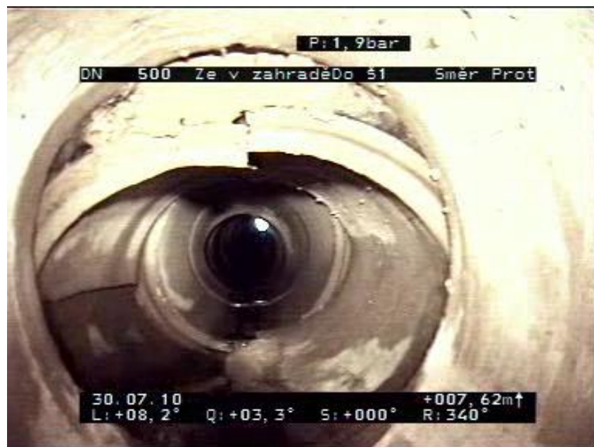
Obrázek 12 - Příklad statického porušení betonových trub kanalizace [10]
