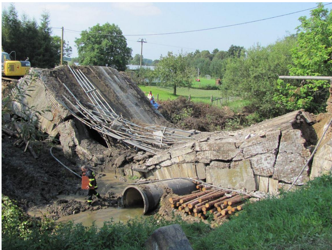
Obr. 18 - Zřícený most ve Vilémově [havlickobrodsky.denik.cz]
