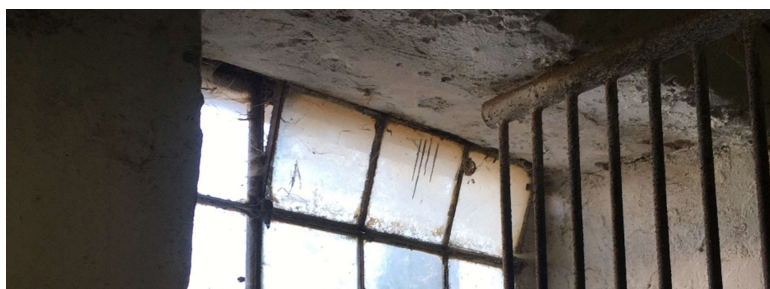
Obrázek 28: Stavební nedokonalost ostění [vlastní]
