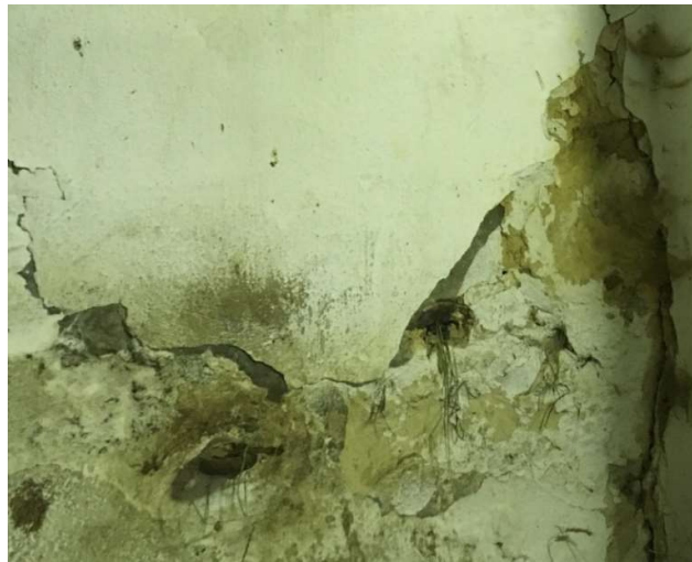
Obrázek 31: Degradace zadní stěny budovy [vlastní]
