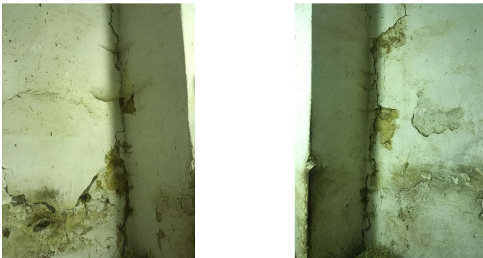
Obrázek 32: Trhliny podél pilíře [vlastní]
