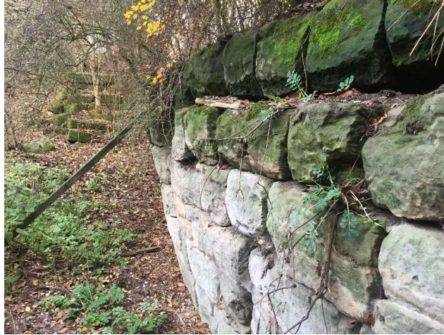
Obrázek 35: Zjevné boulení stěny [vlastní]
