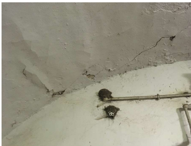
Obrázek 37: Degradace omítky na stropní konstrukci [vlastní]
