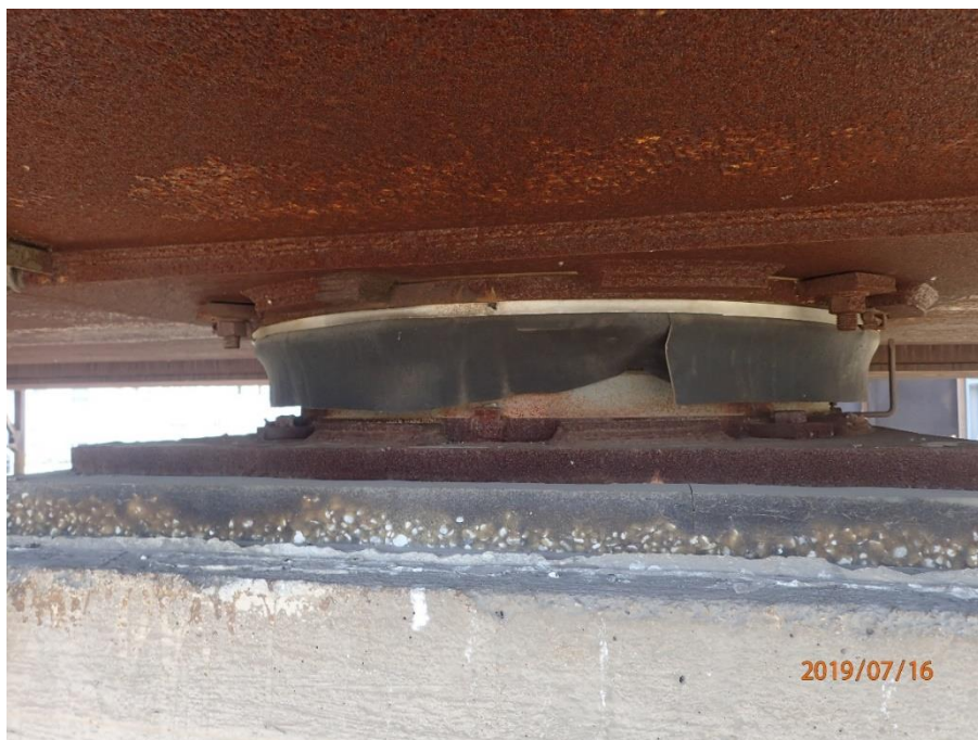
Obr. 18 – Příčně posuvné ložisko (pravé), roztržená ochranná manžeta
