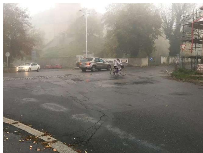
Obr.8 Nevhodně dlouhý přechod
