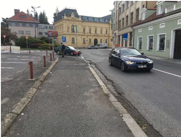
Obr.5: Špatný stav obrub a asfaltových ploch
