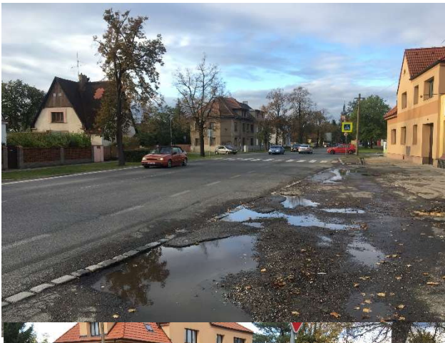
Obr. 8 celkově špatný stav asfaltových ploch
