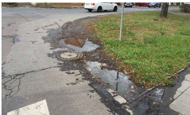
Obr. 10 špatný stav obrub a tvorba kaluží
