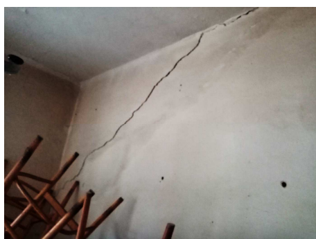
Obr. 38: Šikmá tahová trhlina od sedání
