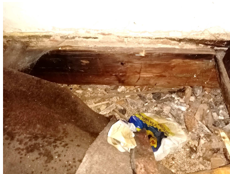
Obr. 43: Pohled na ohořelé zhlaví stropního trámu
