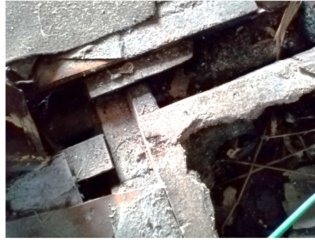
Obr. 42: Pohled na zničený záklop stropních trámů
