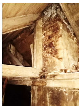
Obr. 39: Poškozený komín požárem
