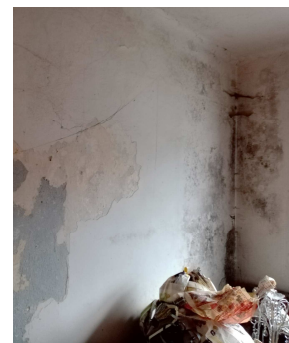
Obr. 35: Opadaná omítka a vlhký roh v interiéru
