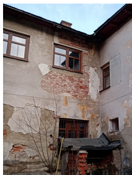
Obr. 34: Poškozená a opadaná omítka v ploše v exteriéru
