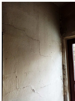
Obr. 45: Trhliny v omítce
