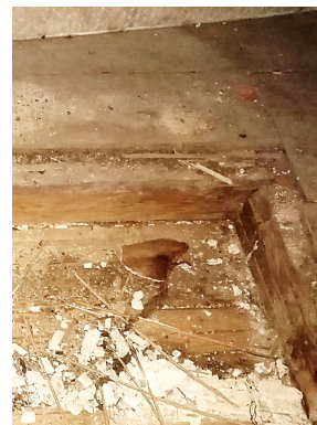
Obr. 17: Podlaha ve 2.NP - prkenný záklop
