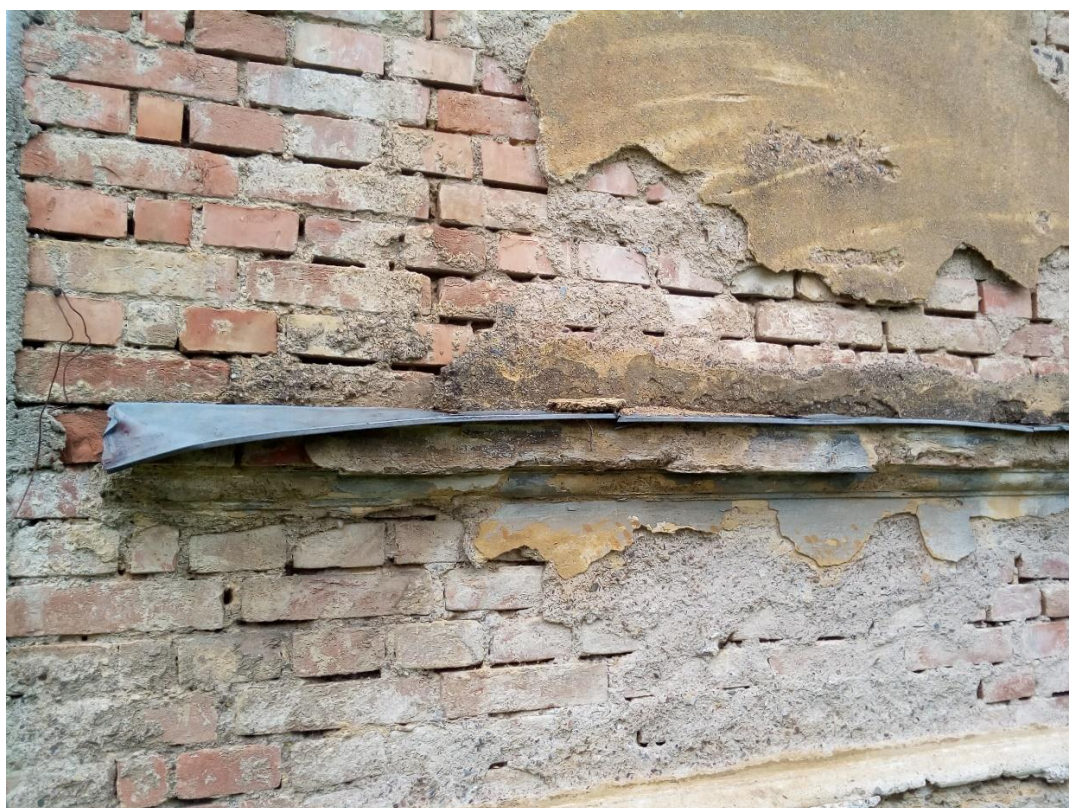
Obrázek 16: Poškozený a zcela nevhodný parapet na jihovýchodní straně farní budovy (Foto autor)
