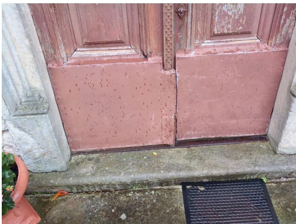
Obrázek 14: Vstupní dveře na severovýchodní straně farní budovy vystavené odstříkující vodě (Foto autor)
