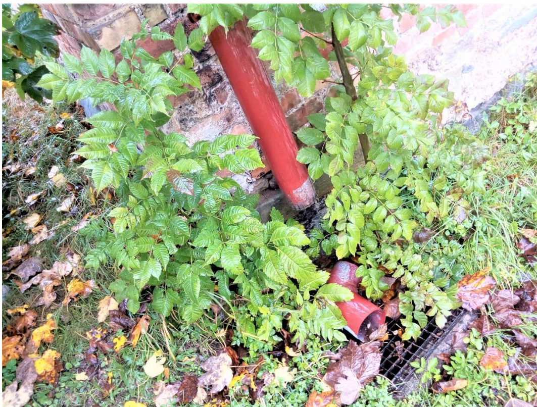
Obrázek 18: Odpadnuté spodní koleno okapového svodu na jižním rohu farní budovy (Foto autor)
