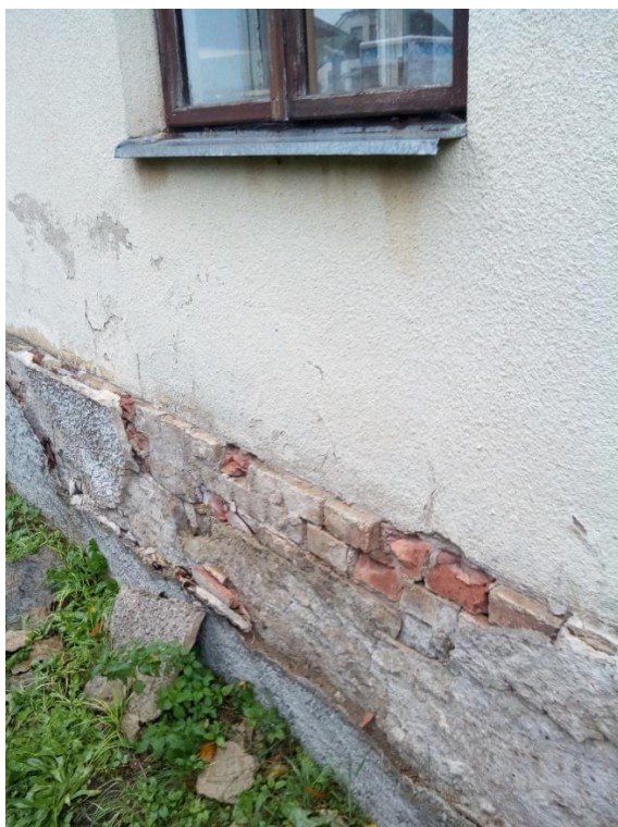
Obrázek 12: Sokl s rozrušenou vnější vrstvou pod parapetem na severovýchodní straně farní budovy (Foto autor)
