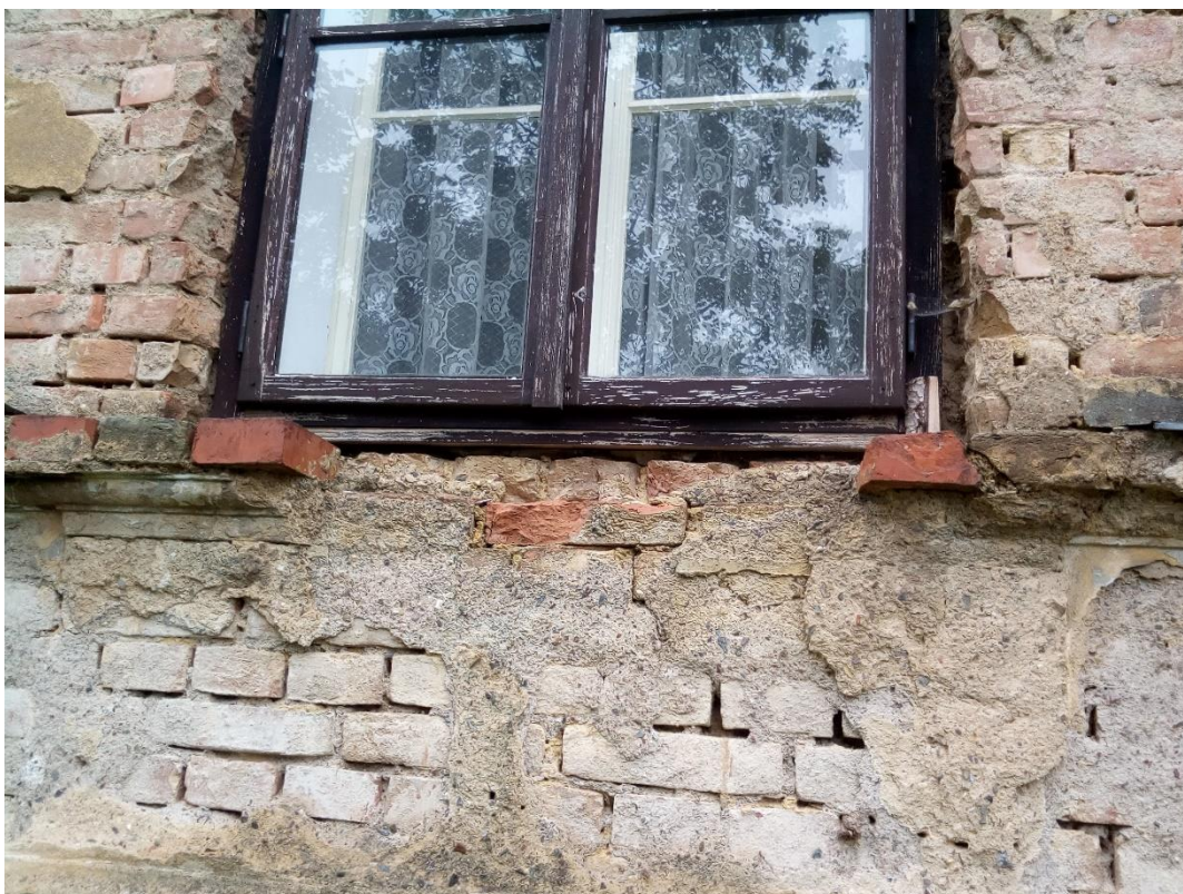
Obrázek 17: Chybějící parapet na jihovýchodní straně farní budovy (Foto autor)
