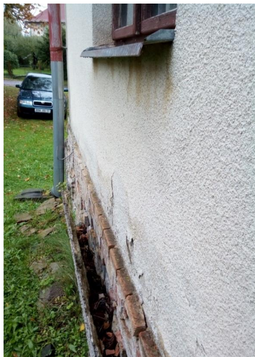
Obrázek 11: Narušený sokl pod parapetem na severovýchodní straně farní budovy (Foto autor)
