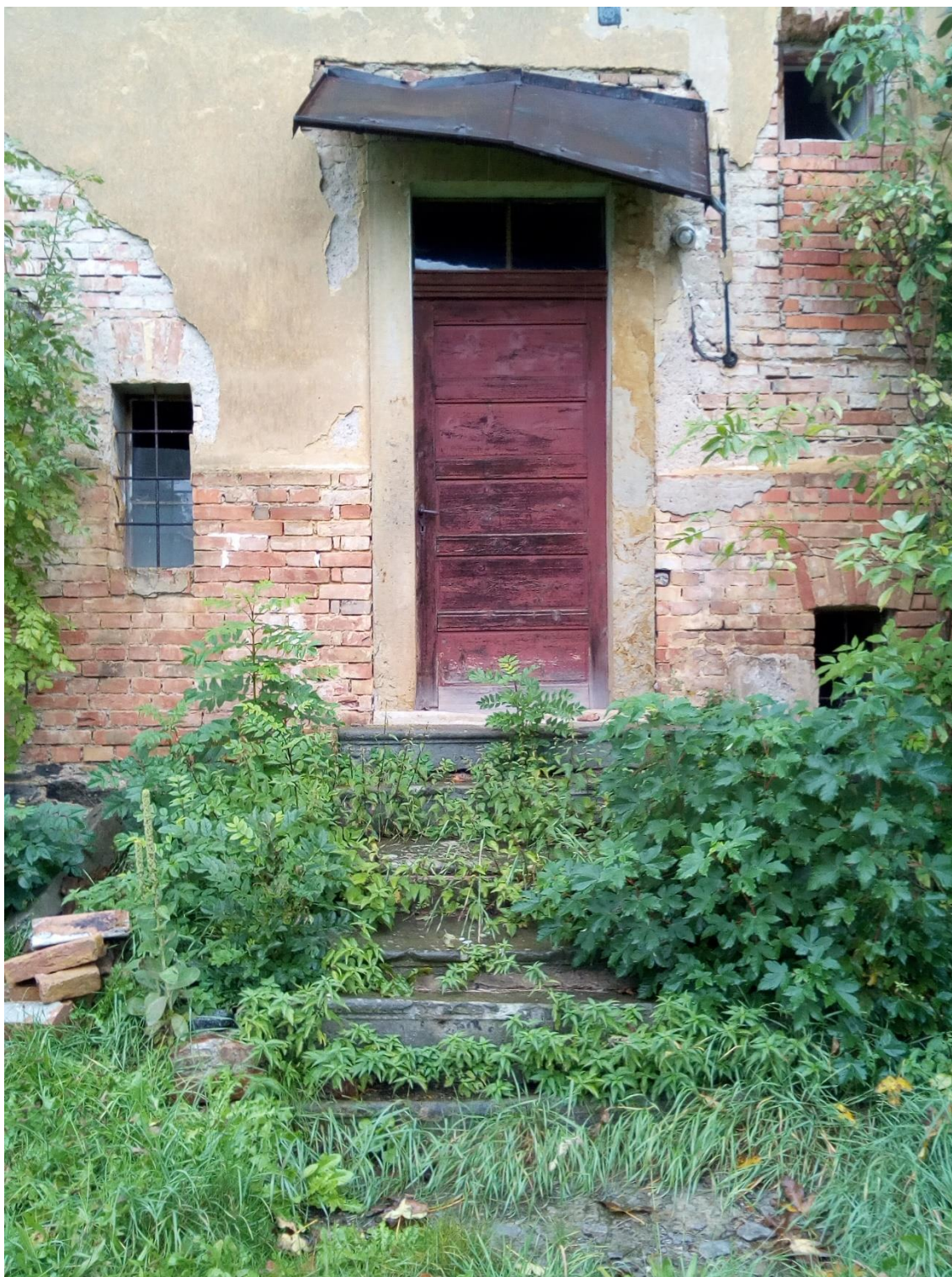
Obrázek 19: Vstupní schodiště z farní zahrady – schodiště je v havarijním stavu vlivem mrazových cyklů a biodegradace, stříška nad schodištěm silně poškozena (Foto autor)
