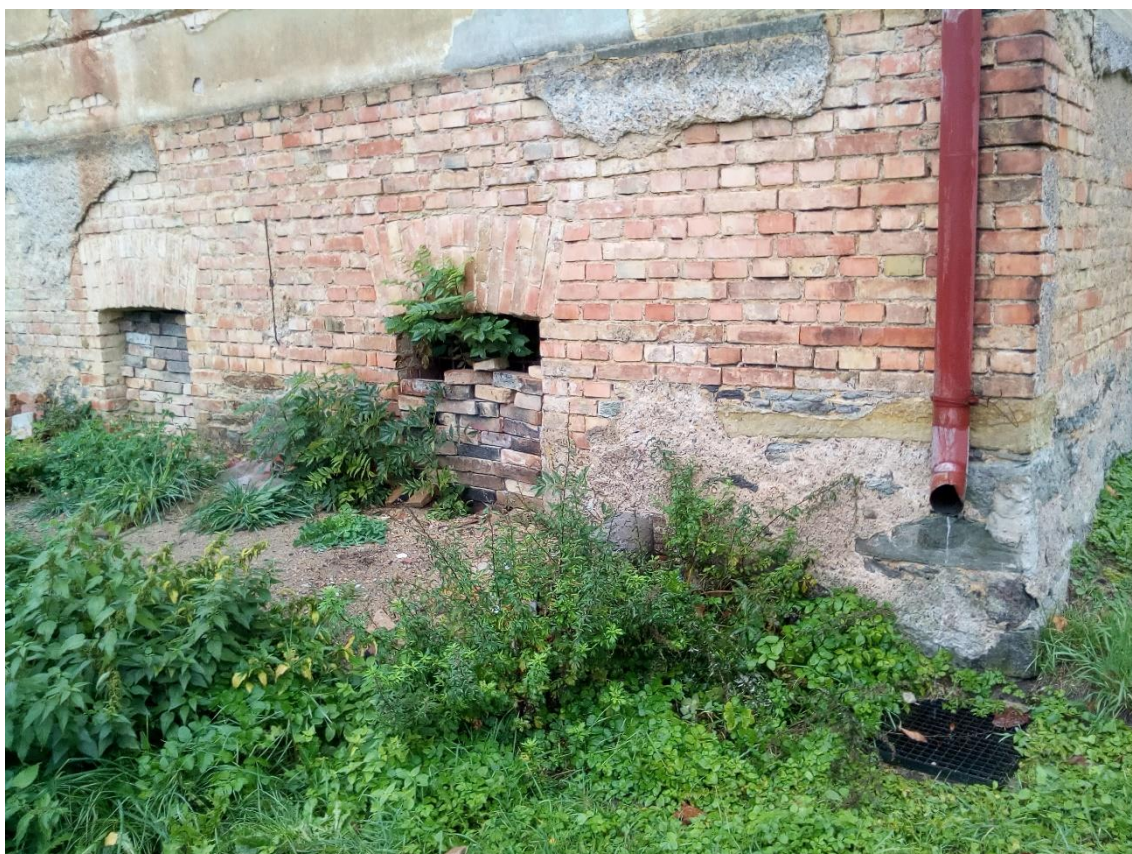
Obrázek 21: Jihozápadní strana farní budovy s navážkou u paty domu (Foto autor)
