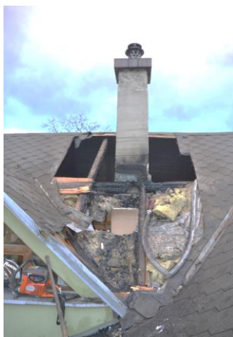
obr. 56: Pohled na požárem zasaženou část střešní konstrukce
