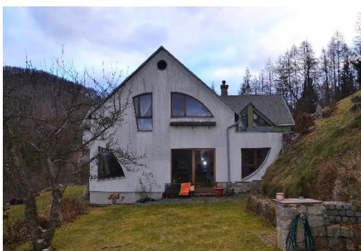
obr. 55: Pohled na JZ průčelí požárem zasaženého objektu
