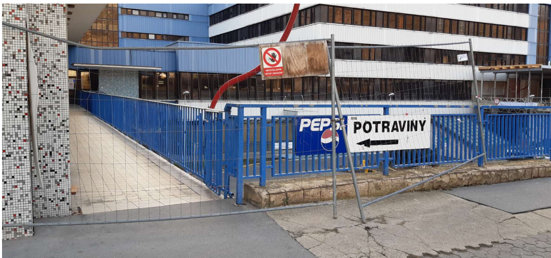
Obrázek č.19: Ve veřejném prostoru nemocničního areálu FNM, který je navštěvován značným množstvím návštěvníků/pacientů (včetně dětí) je vhodné dodržet vyšší úroveň standartu zařízení staveniště (pořádek, organizaci, zabezpečení).
