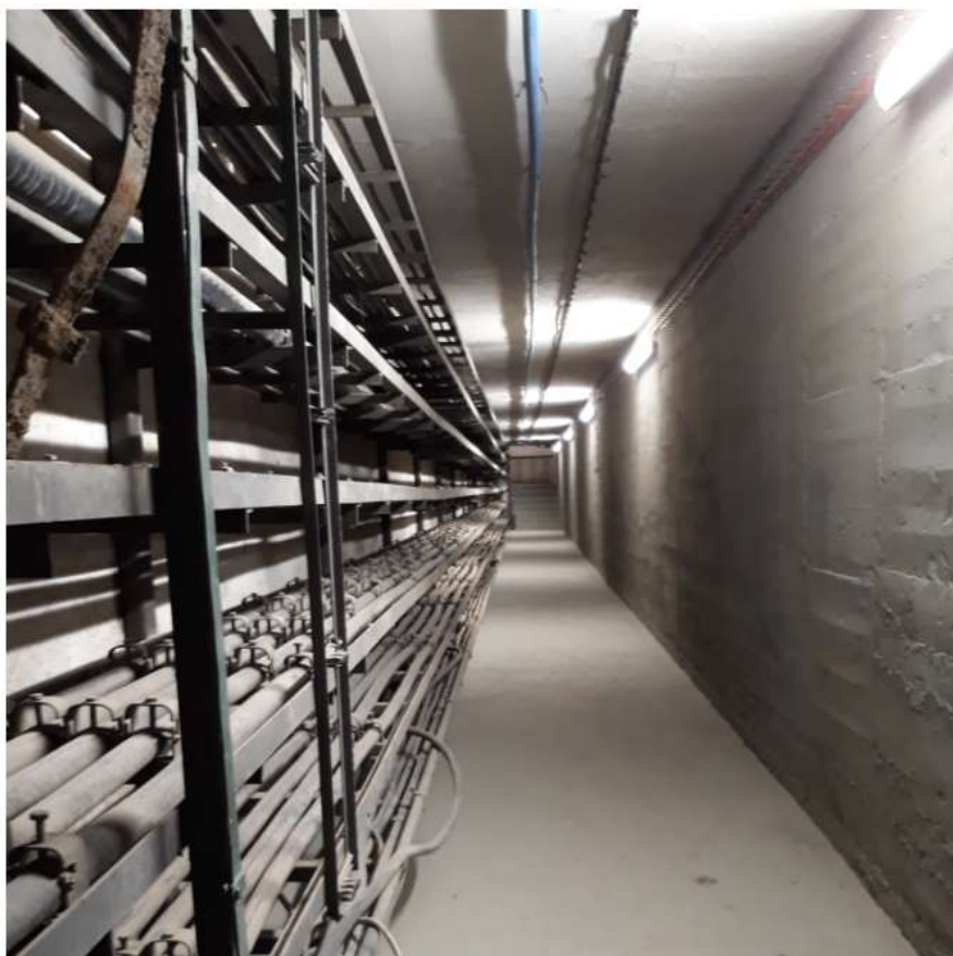
Obrázek č. 15: Fotografie vedení IS v technické chodbě v areálu FNM
