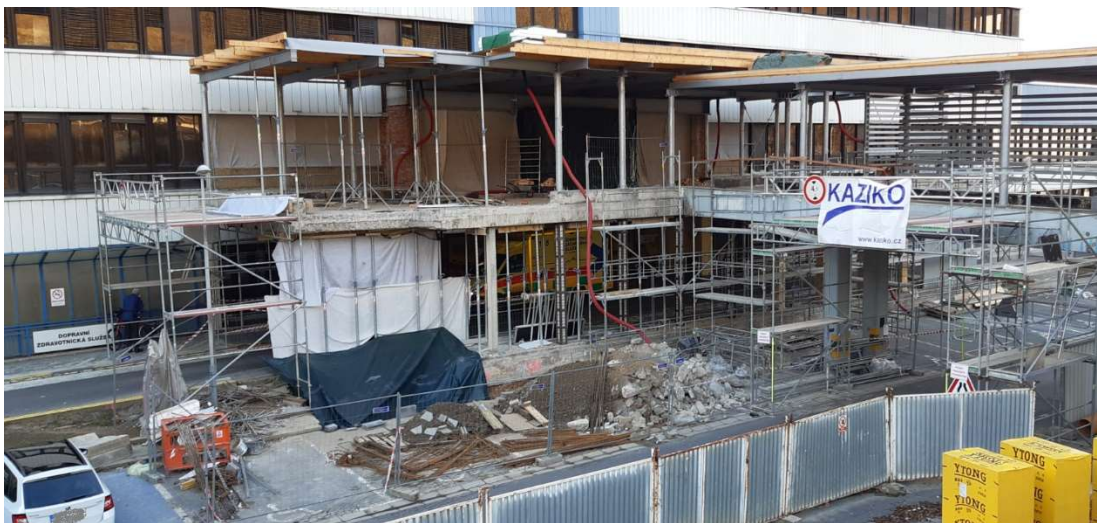
Obrázek č.17 a 18: Zábór parkovací plochy pro uskladnění výkopku před hlavním vstupem na pohotovost (EMERGENCY) FNM. Dále zábór parkovacích míst pro invalidy, pro uskladnění přebytečné armatury a stavební sutě.
