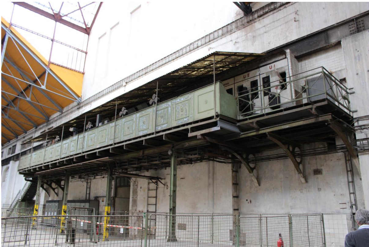
Obr. 44 Zachovalá galerie v hale strojovny, zdroj [9]
