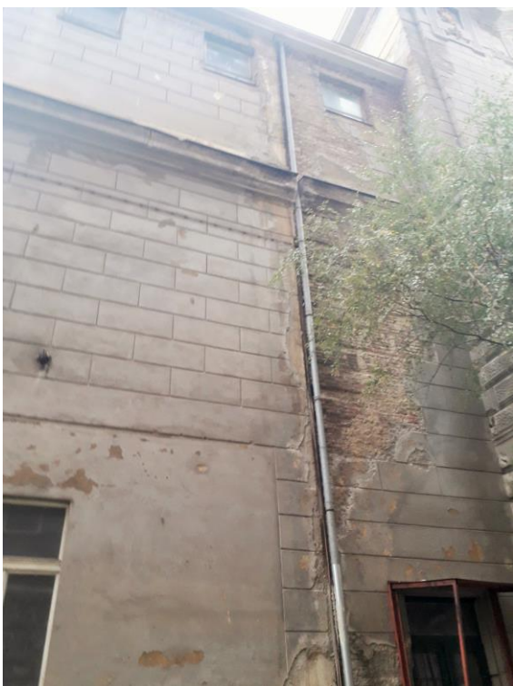
Obr. 46 Venkovní omítka poškozená srážkovou vodou
