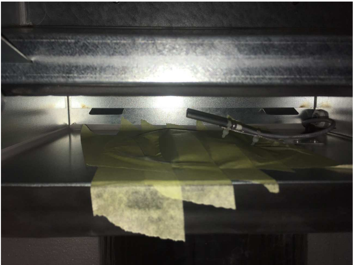
Obrázek 5: Zatěsnění odvodu vzduchu z interiéru do VZT jednotky
