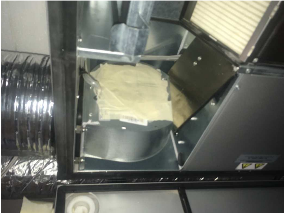
Obrázek 3: VZT jednotka DUPLEX 170 EC5 umístěná v suterénu, na fotce je vidět utěsnění přívodu čerstvého vzduchu
